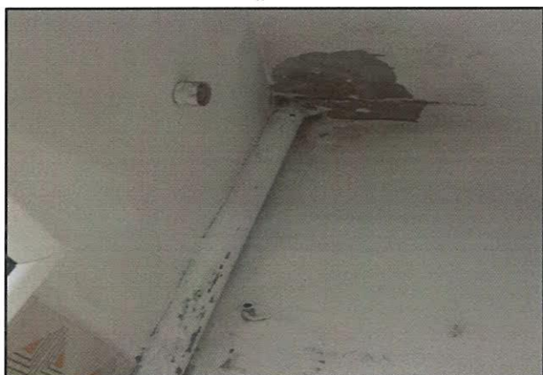
Снимка 77 – Канализационна тръба и следи от течове
