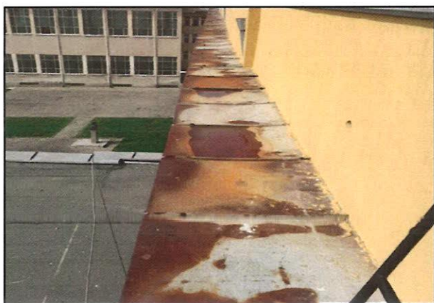
Снимка 121 – Нарушено покритие от поцинкована ламарина
