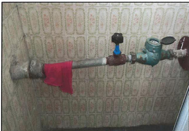
Снимка 71 – Водомерен възел
