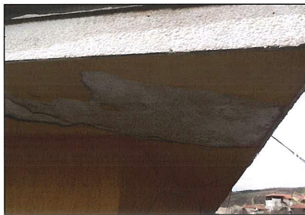
Снимка 122 – Следи от теч по козирка
