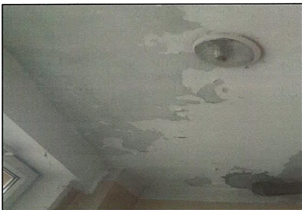
Снимка 17 – Опадала мазилка по таван, дървена облицовка по стени
