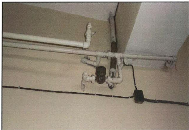
Снимка 92 – Кабели, монтирани открито по стена
