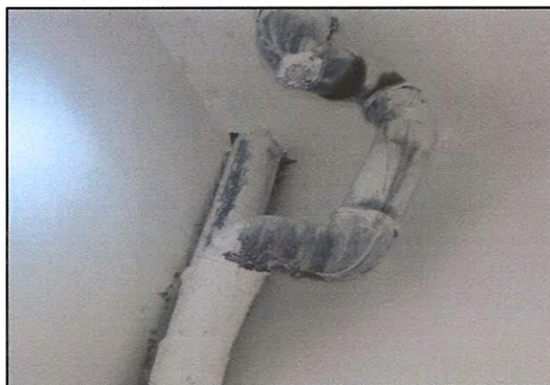
Снимка 78 – Канализационни тръби
