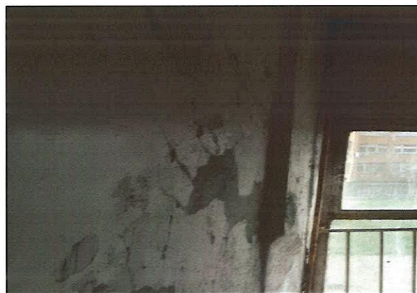
Снимка 116 – Следи от течове и опадала мазилка на последен етаж
