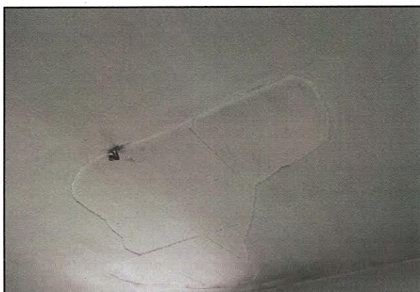
Снимка 117 – Следи от течове и опадала мазилка на последен етаж
